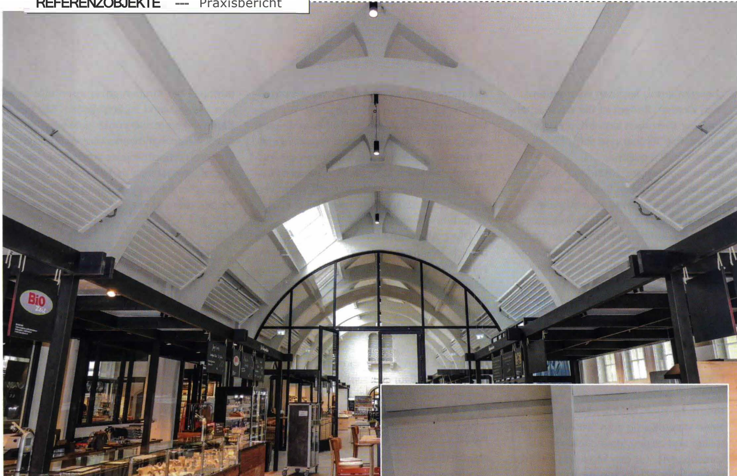
Die Markthalle Herford wurde umfassend saniert und dabei mit Deckenstrahlplatten ausgestattet.
