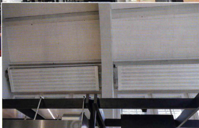
Die Deckenstrahlplatten KSP Akustik ließen sich variabel in die Zwischenräume der tragenden Konstruktion einpassen.
